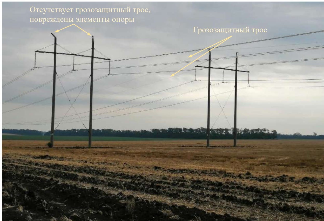
Рис. 6. Повреждения ВЛ 330 кВ
