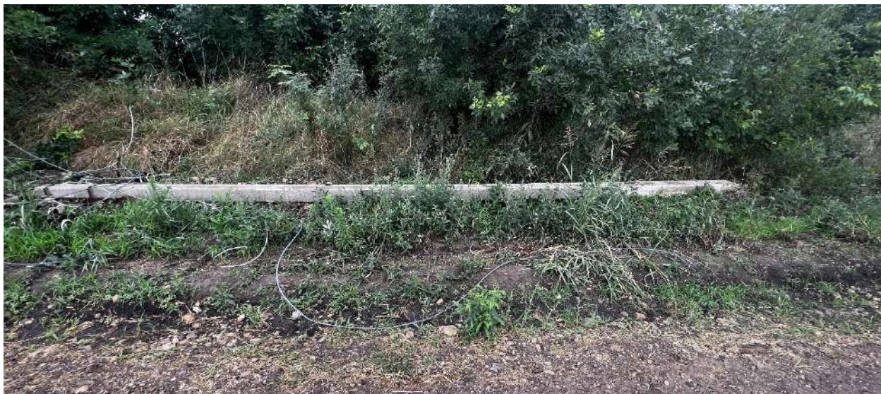
Рис. 7. Повреждения опоры №86 ВЛ 10 кВ ПР-9
