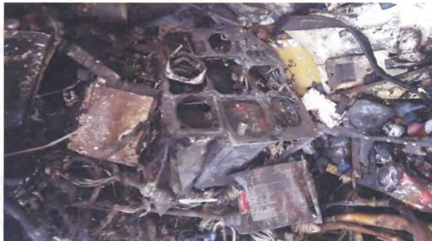
Fig. 1.3.2 El tablero de instrumentos quedaron destruidos por impacto
