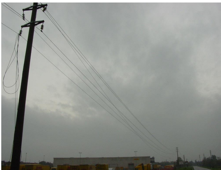
Foto 2: dettaglio dei danni all'elettrodotto.
