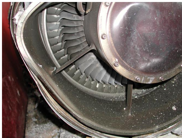
Foto 29: particolare della turbina di bassa pressione del motore destro.
