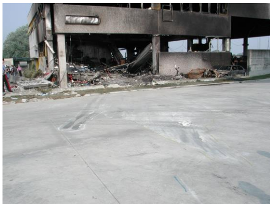
Foto 7: tracce dell'impatto sul piazzale.
