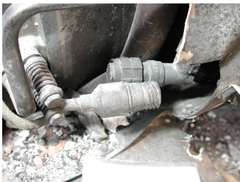
Foto 24: disconnessione del cablaggio collegante il trasduttore con il DEEC del motore sinistro.
