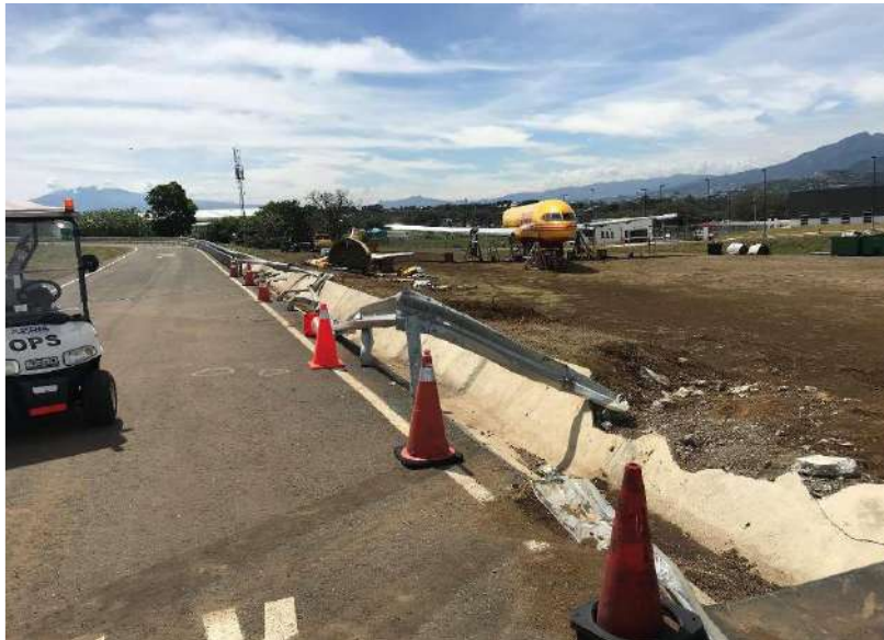
Imagen 17: Daños a la cerca de protección.
