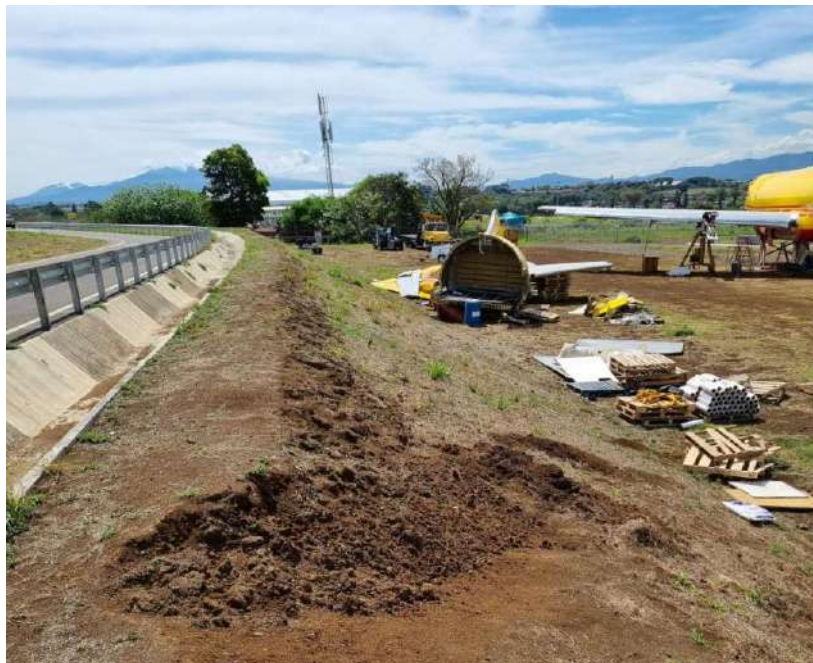
Imagen 20: Daños a taludes y canales 1.
