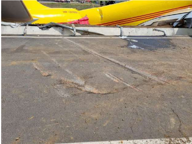
Imagen 16: Daños al pavimento.
