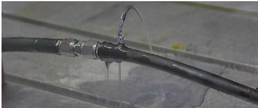
Imagen 59: Área de fuga de la manguera de retracción del actuador de bloqueo descendente L/H MLG.
